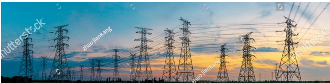
Мал. 19.1. ЛЕП — лінії електропередач
